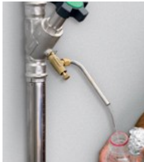
Probenahme am Hauptverteiler
