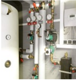
Warmwasser-Großanlage mit Speicher > 400 Liter
